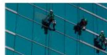
Protección contra caídas
